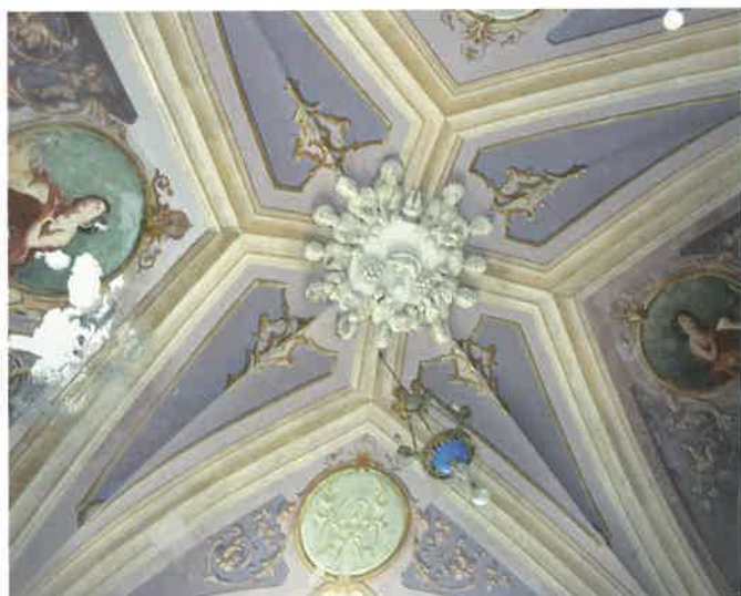
Le décor en stuc de la Cène et les 2 médaillons peints de saint Jean avant restauration.
