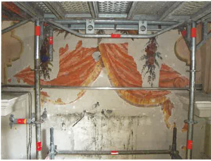
Décor de draperie en trompe-l'œil en cours de dégagement, à l'emplacement du retable du Rosaire.
