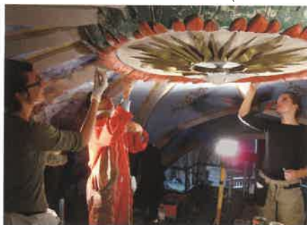
En 2015, l'équipe de restauration de Christine Guilloud intervenant sur la voûte du chœur.
